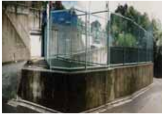
従前の防災調整池(約500m 3 規模)
