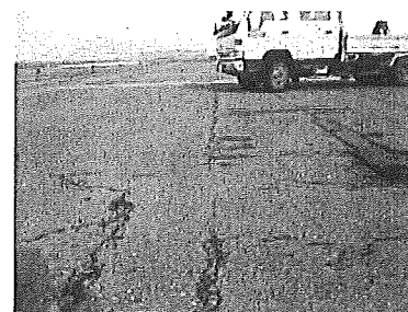
【誘導路の劣化状況】
