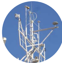
観測を行う測量船「明洋」と、マストに設置されているGPSアンテナ。
