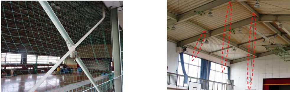
■ 図 7.5.4 鉄骨造建築物の被害状況
