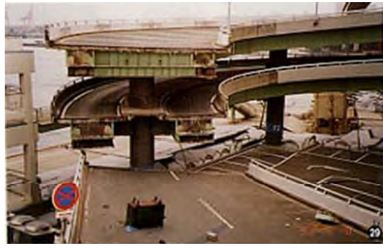
地震により崩落した橋梁
