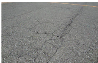
(老朽化した基本施設舗装)
