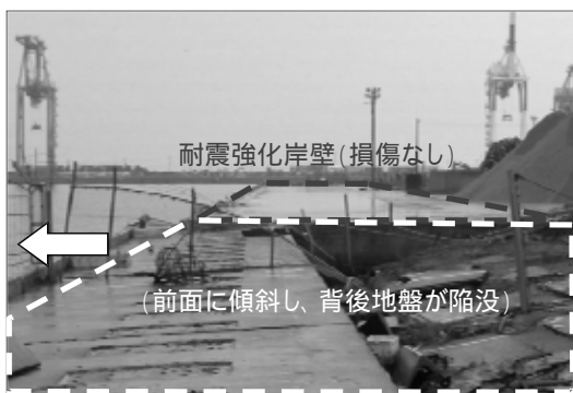
被災状況(仙台塩釜港)
