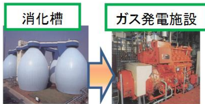
図 3-28 バイオガスの利用事例（横浜市北部汚泥資源化センター）
