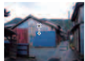
× 異なる材料のちぐはぐな補修
