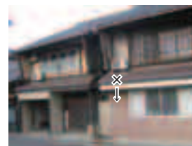
× 異なる材料のちぐはぐな補修
