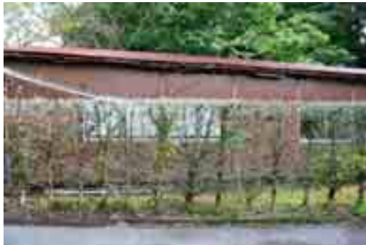
写真6-2 D：全被害を受けたもの
