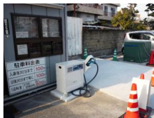
丸五モータープール(急速充電器)
