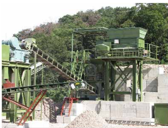
写真 6-9 瓦粉碎プラント
