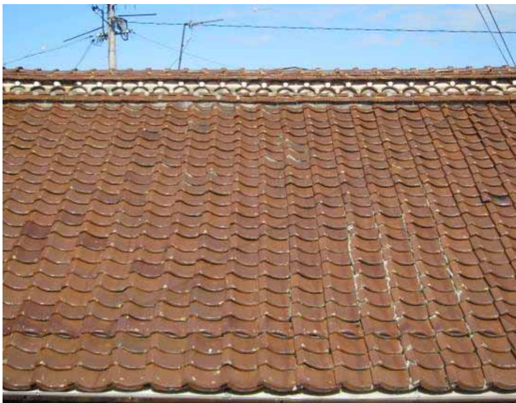
写真 3-26 雨漏り対策として漆喰を埋め込んでいる屋根
