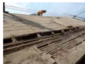
写真 2-2 野地板の腐食
