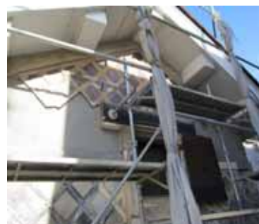
写真 4-4 東日本大震災で破損した建物（須賀川市）
