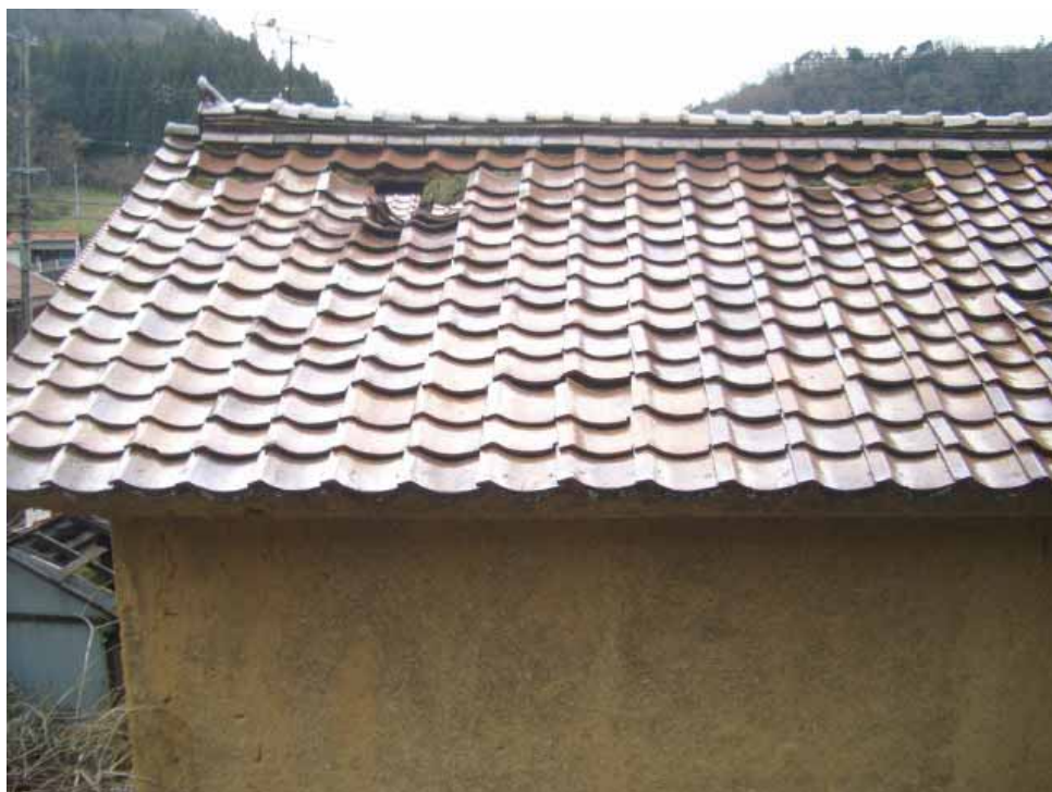
写真 3-27 雨漏りによる野地板が腐食した屋根
