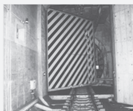
トンネル内防水ゲート
