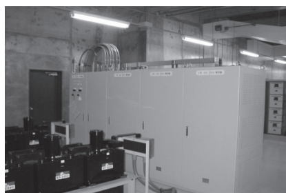
【通信設備の一例】
