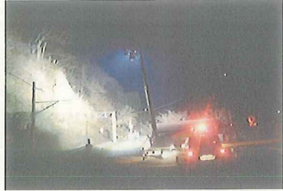
JR 大糸線の被災箇所（小谷村）に派遣中の照明車（11 月 23 日未明）
