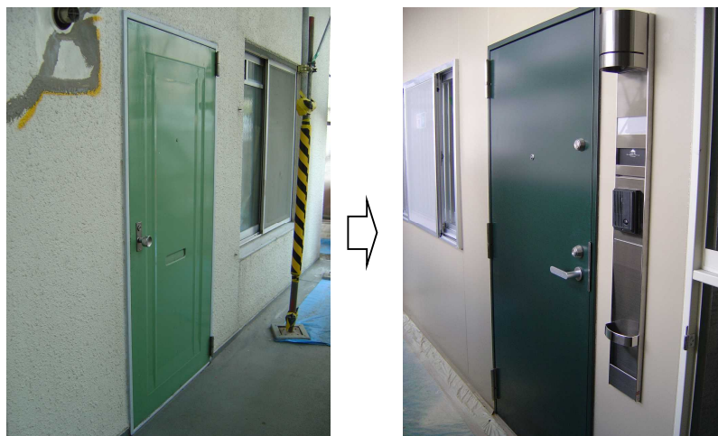
ドアの取替えにあわせた住戸ドア周りのグレードアップ(門灯、室名札、インターホン、新聞受けホルダーが一体となった玄関ドア脇パネルの新設)
