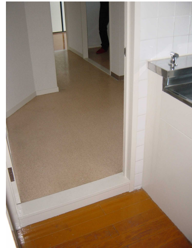
台所から開口した壁を通して見たところ。 水回り部は一段高くなっている
