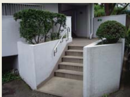
バリアフリー化されていない玄関前の段差
