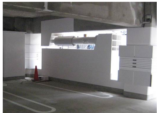
免震装置と減衰装置の設置状況
