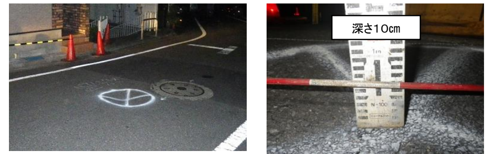
東京都北区での陥没事例（平成25年8月）
