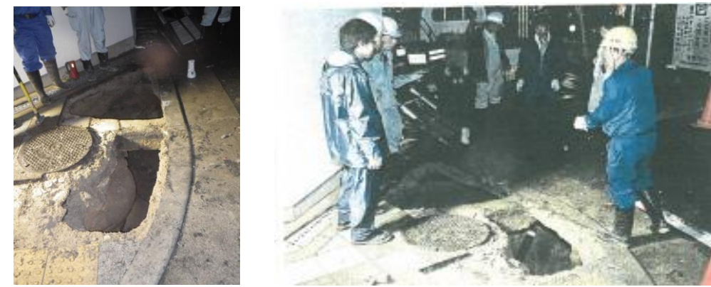
大阪府豊中市での陥没事例（平成25年9月）
