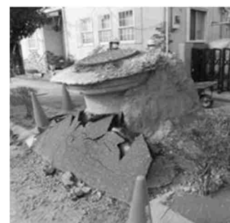
液状化により隆起したマンホール (浦安市)
