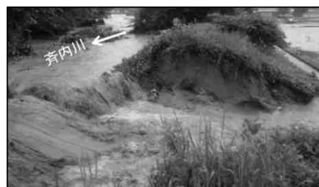
秋田県 大仙市 雄物川水系斉内川の破堤の様子
