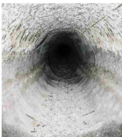
硫化水素で腐食した管渠
