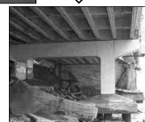
西湘海岸の被災状況（神奈川県二宮町）
