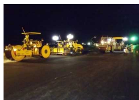
(老朽化した滑走路舗装の改良)
