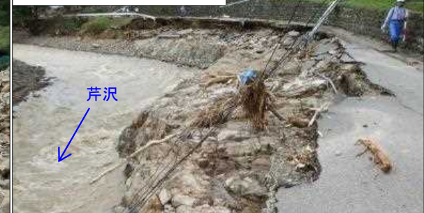
市道芹沢線の崩落状況
