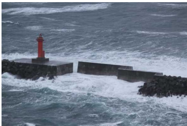
高波による防波堤の被災例
