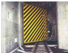
トンネル内防水ゲート
