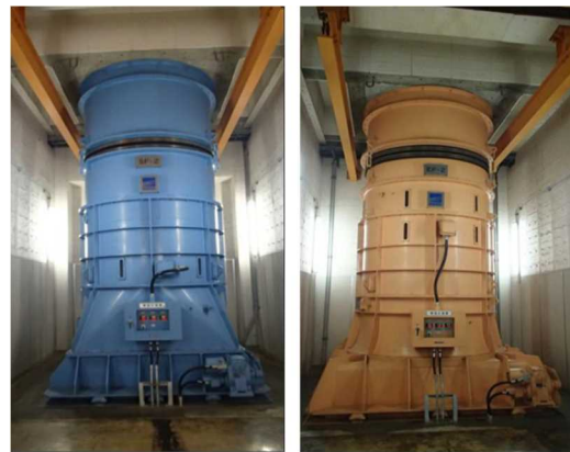
送・排風機設備の事例
