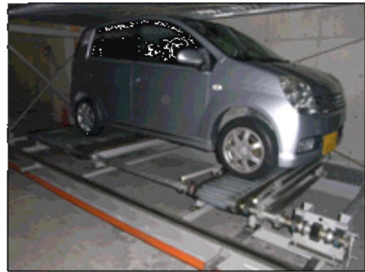
機械式駐車場設備の事例
