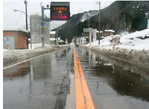
消融雪設備の事例
