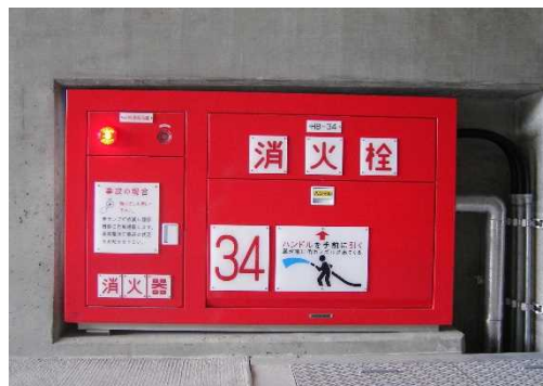
トンネル非常用施設の事例
