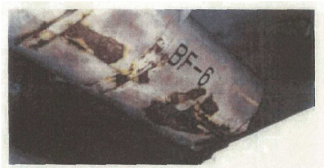
写真－４ 発錆、腐食状態のランク [E]
