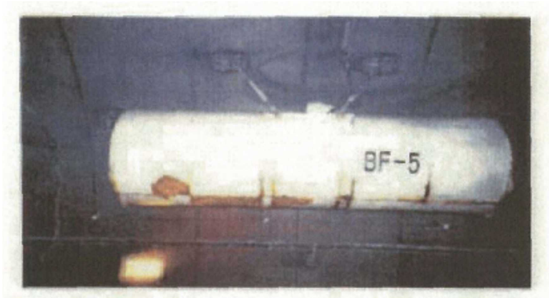
写真－３ 発錆、腐食状態のランク [D]
