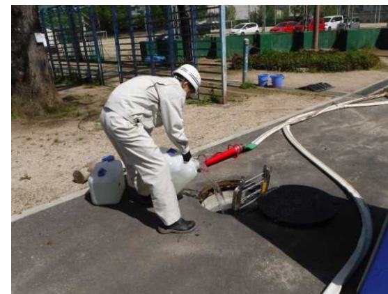
排水管内の洗浄水を トイレ上流の マンホールから投入
