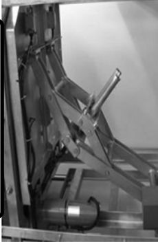
換気口浸水防止機
