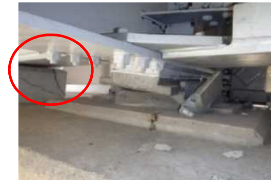
支承の破損の状況
