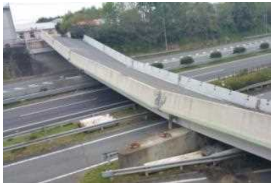
ふりよう ＜府領第一橋(熊本県道)の落橋＞
