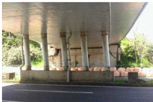
ひがしはる ＜東原橋(熊本ICランプ橋)の傾いた橋脚＞
