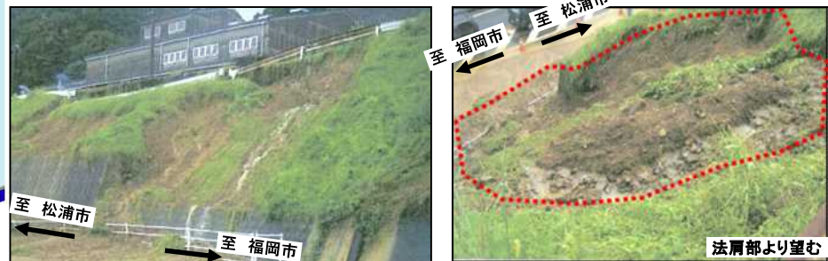
《法面崩壊写真》
