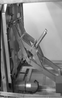
換気口浸水防止機
