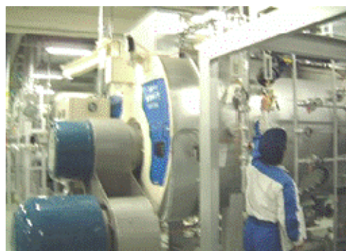
冷凍機の定期点検
