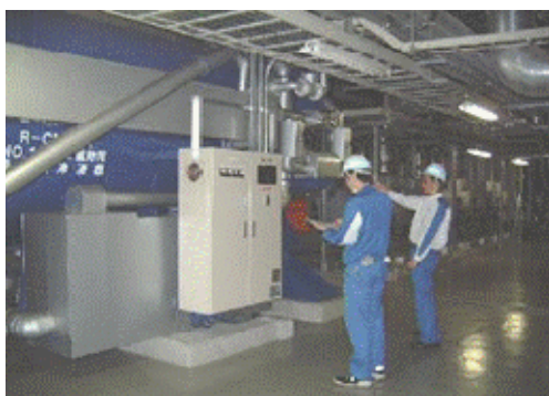
ボイラーの定期点検
