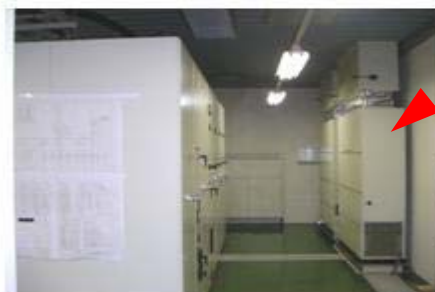
電気室冷却用パッケージ空調機
