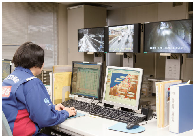
道路情報管理室には監視カメラの映像や管理区間の情報が集まる。
