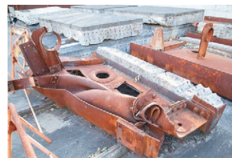
火災を受けて鉄がねじり曲がった橋の一部
