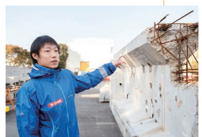
内部の金網の腐食状態を見るため所々切り取られた橋桁の一部
