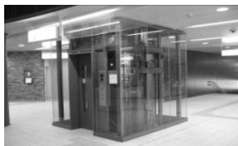
エレベーター
