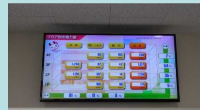
BEMS画面：BEMS導入により、電力の使用状況を設備グループごとに詳細に見える化し電力使用量の抑制を図るとともに、従業員の省エネ意識の向上が期待できる。
