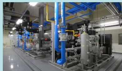
アンモニア/CO2冷凍機：最先端の冷凍設備を完備し、冷媒もアンモニア/CO2を使用し、従来の設備とは違い冷媒量も少なく環境に配慮した設備になっている。
