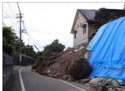
《H28 熊本地震での小規模擁壁被害》
