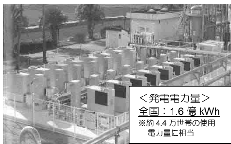
バイオガス発電
