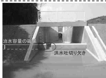
洪水吐切り欠きの設置により治水容量の確保を行った事例
