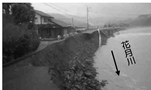
堤防洗掘（花月川右岸 6.4k 付近） 大分県日田市
