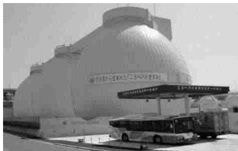
バイオガスを精製して自動車燃料として供給
