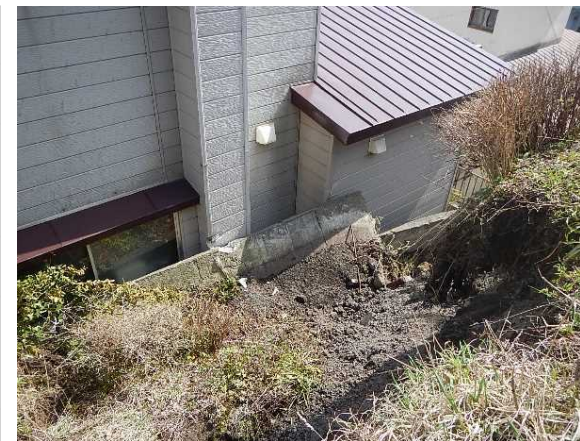
※崩落したコンクリート製擁壁が斜面下の家屋を直撃
