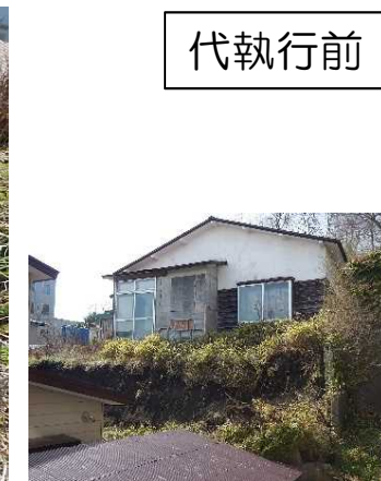
※上部の法面も崩落し空き家が倒壊のおそれ
