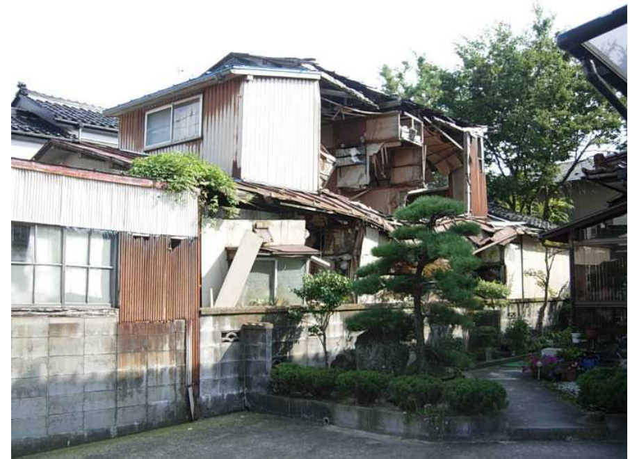
※老朽化により建物の一部が隣家へ崩落
