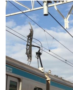
1034B パンタグラフ損傷
