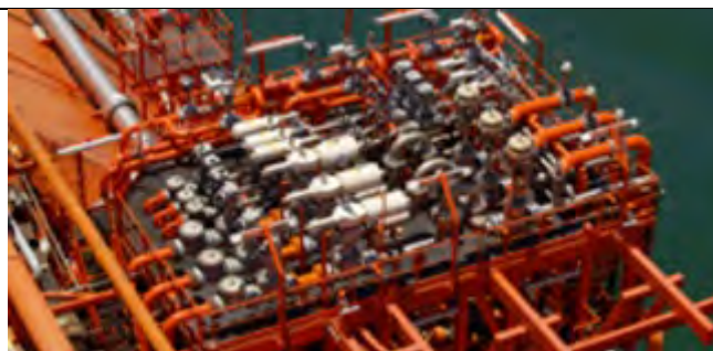
Moss LNG Regasification System
