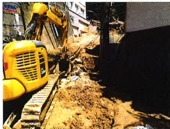
私道の土砂撤去状況（神戸市灘区篠原台）
