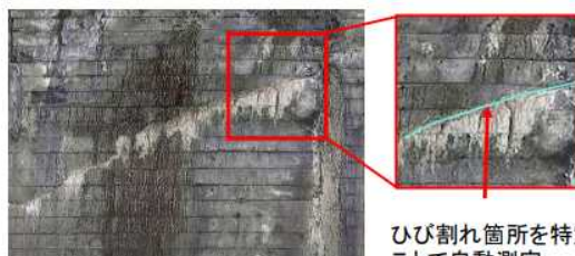
より小さなひび割れ(幅0.3mm程度)を確認可能 ひび割れ箇所を特定することで自動測定 (例)幅1.0mm 長さ35.0mm
