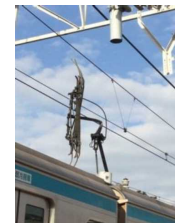
1034B パンタグラフ損傷
