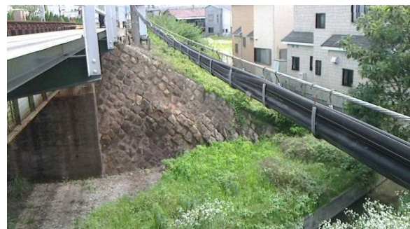
石積擁壁変状・軌道変位（茨木市～総持寺駅間）
