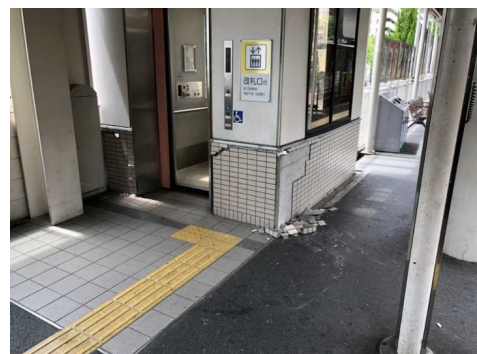
南茨木駅下りホームEVシャフト損傷
