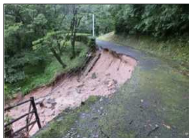
法面崩落(広島県安芸郡坂町)
