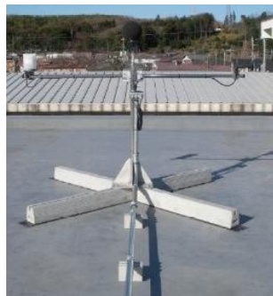
騒音測定局(屋上設置時)
