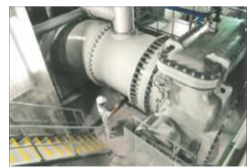
雨水ポンプの整備
