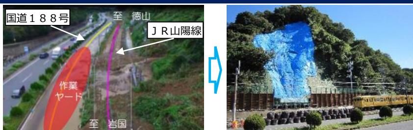
被災直後 復旧後
