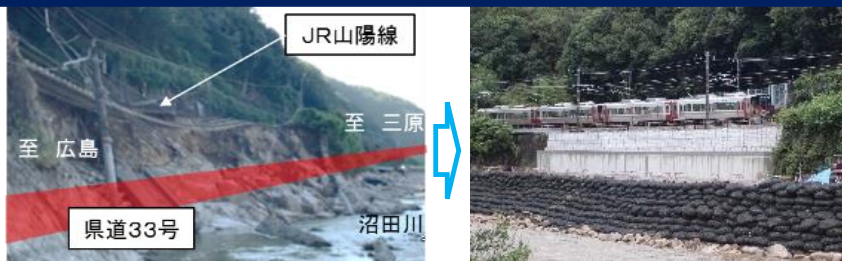
被災直後 復旧後
