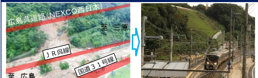
被災直後 復旧後
