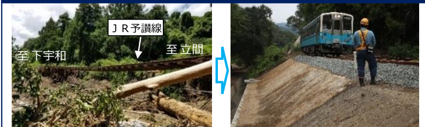
被災直後 復旧後
