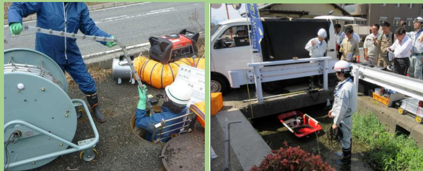
下水道管路点検支援技術
