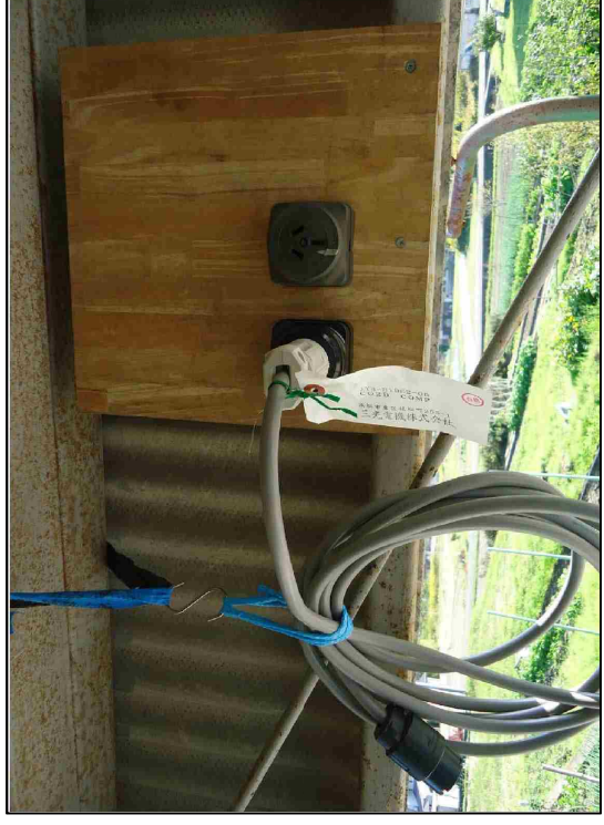
▼ 倉庫内の電源(200V×2口)
