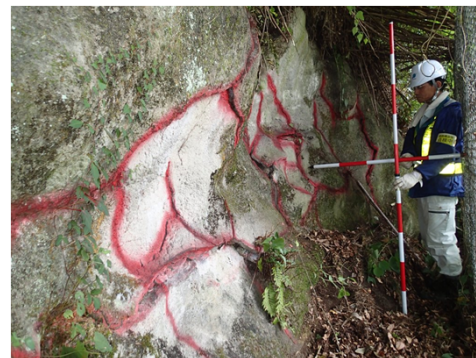
岩石崩壊のおそれ
