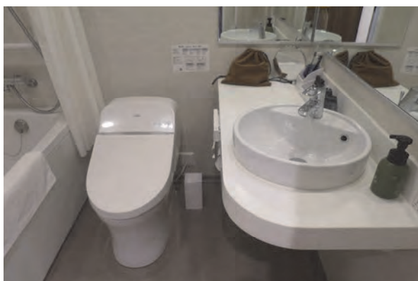
・下部に車椅子使用者の膝が入るスペースを確保した洗面台
